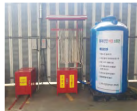
〈송도2교 창고 비상용 옥외 소화전〉
