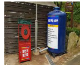
〈동심원 내 비상용 옥외 소화전〉
