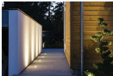
출입문으로 가는 통로에 설치된 조명 [뉴질랜드]
