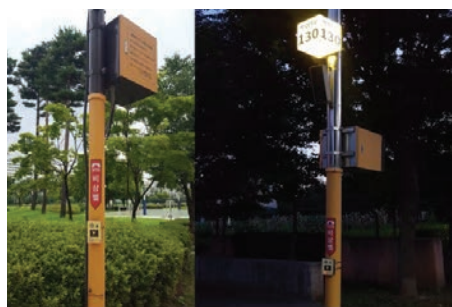
음성지원, 비상벨, CCTV, 현위치 안내사인 통합설치 [경기도 동두천시 주택밀집지역]
