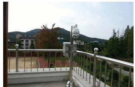
옥상 및 지하공간, 기타 후미진 공간에 필요시 CCTV 설치
