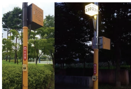
CCTV는 감시의 사각지대를 중심으로 조명, 안내시설, 비상벨을 함께 설치
