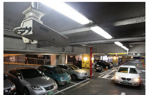
지하 주차장 출입구, 이동경로, 주차구역, 사각지대를 볼 수 있는 위치에 CCTV 설치
