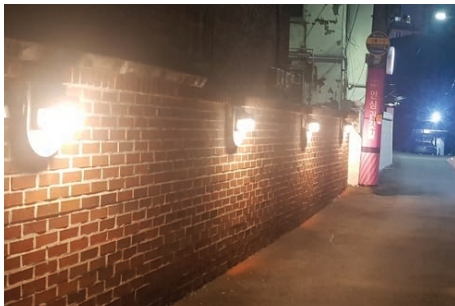
눈부심 방지를 고려한 주택가 주변 벽등 설치 [경기도 수원시 팔달구 고등동]
