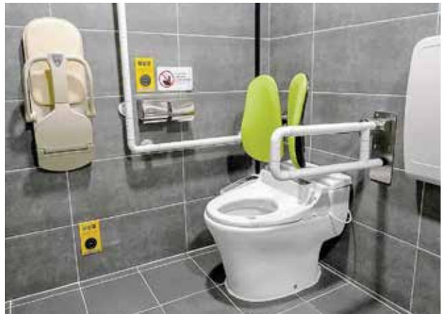
대변기 등받이와 영유아 거치대가 비치된 다목적 화장실
