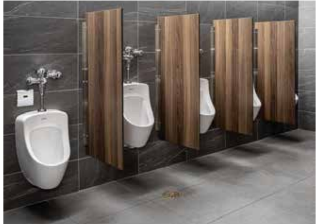
어린이 소변기 접근성을 고려한 화장실
