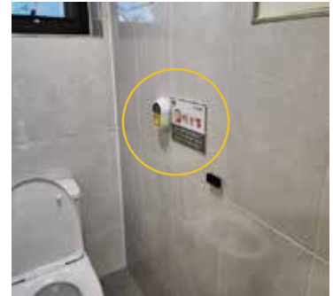
[그림3] 손에 닿기 쉬운 높이에 설치된 비상벨
