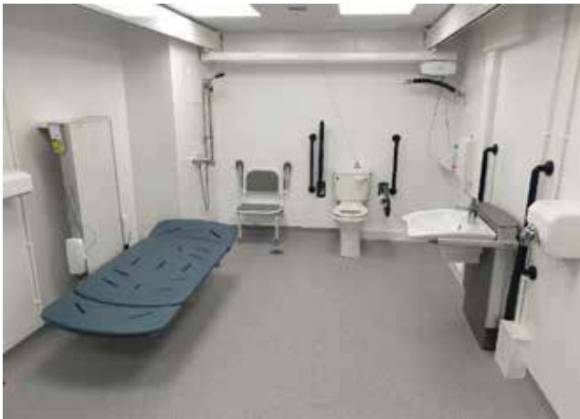
장애인 특수장비(너싱벤치)가 설치된 화장실
