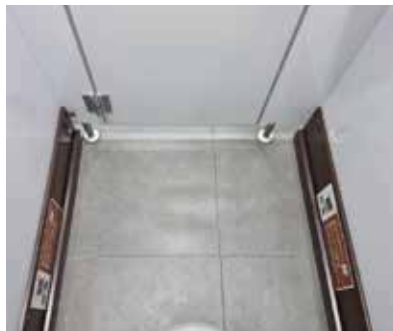
[그림5] 대변기 부스 칸막이 하단 안심스크린 설치
