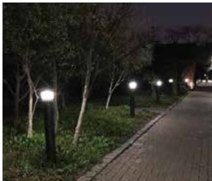
화장실 접근로 유도등(보안등) 설치 예시
