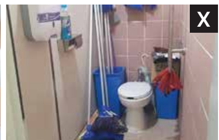
화장실 내부 장애인화장실 내 청소도구함 금지
