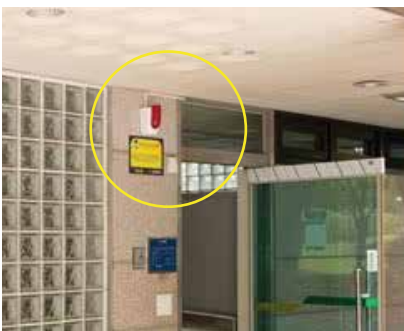
화장실 경광등 설치 예시
