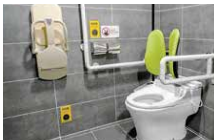
다목적 화장실 내 비상벨
