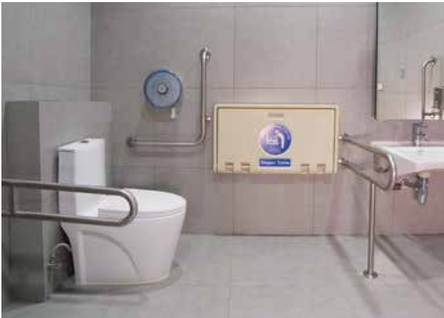
다목적화장실 내 선반, 휴지걸이 등 편의시설
