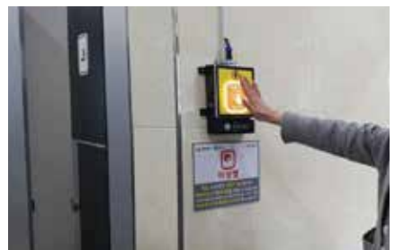
세면대 주변 비상벨 설치
